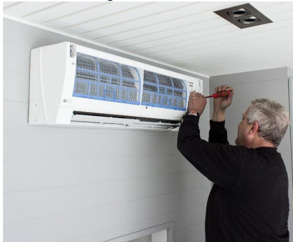
Wand-afgiftesysteem van een lucht/lucht-warmtepomp.
