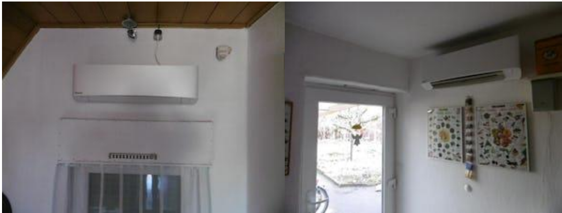
De airco-unit op de eerste verdieping
