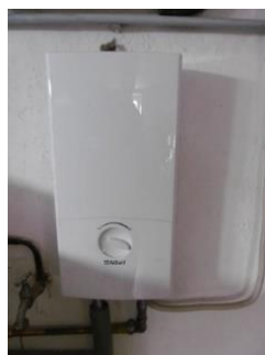
De 21 kW grote elektrische doorstromer voor warm tapwater.
