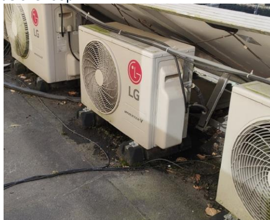
Enkele van de inmiddels vier buitenunits op een rij.
